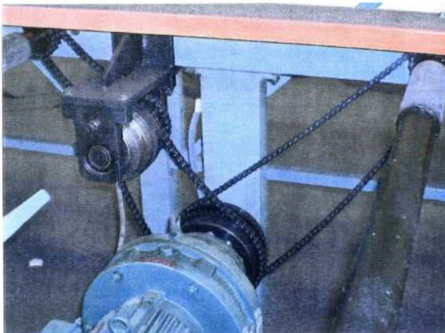
Bild 18: offen laufende Antriebsketten
