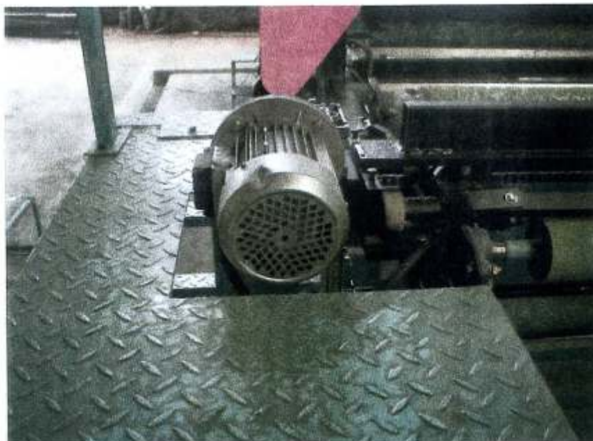
Bild 9: Motor auf dem Laufgang
